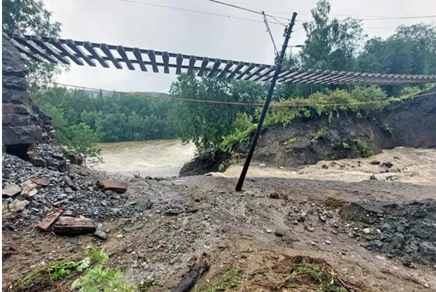
Figur 5-1: Vannmasser har tatt med seg fylling under sporene på Viul, nær Hønefoss. (Foto: Johnny Lundh, Spordrift, (BaneNor, u.å.)
